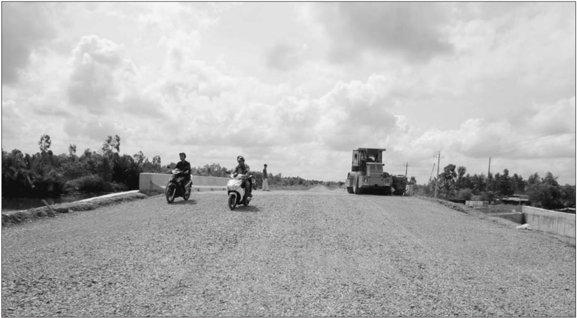
Một số hạng mục của Dự án QL1 qua tỉnh Hà Tĩnh, Quảng Bình đã phát sinh thêm chi phí Ảnh: TK
